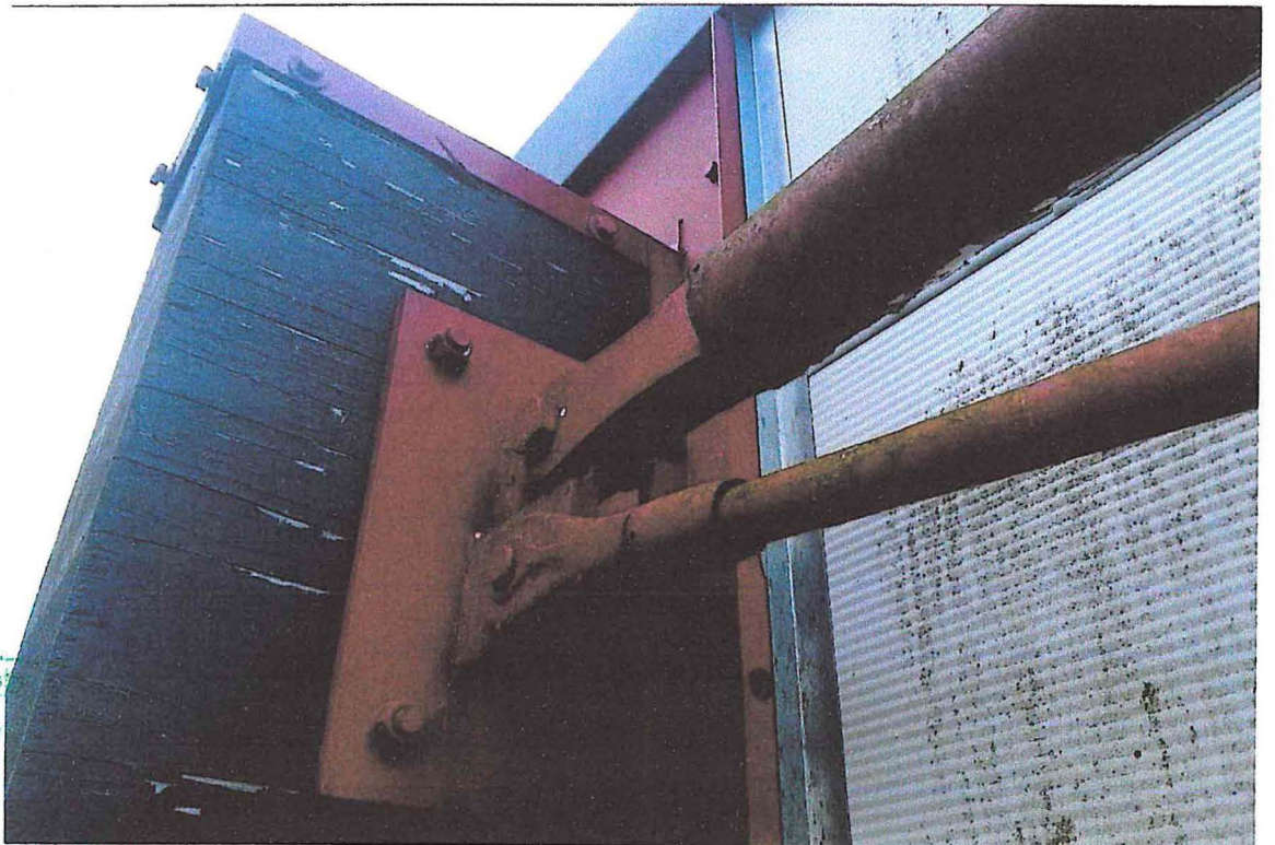
Gelöste Schraubverbindung bei der Stahlabdeckung
