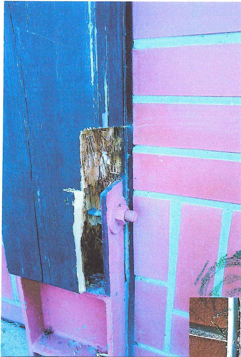
Freigelegter durch BR geschädigter Stiel Westfassade
