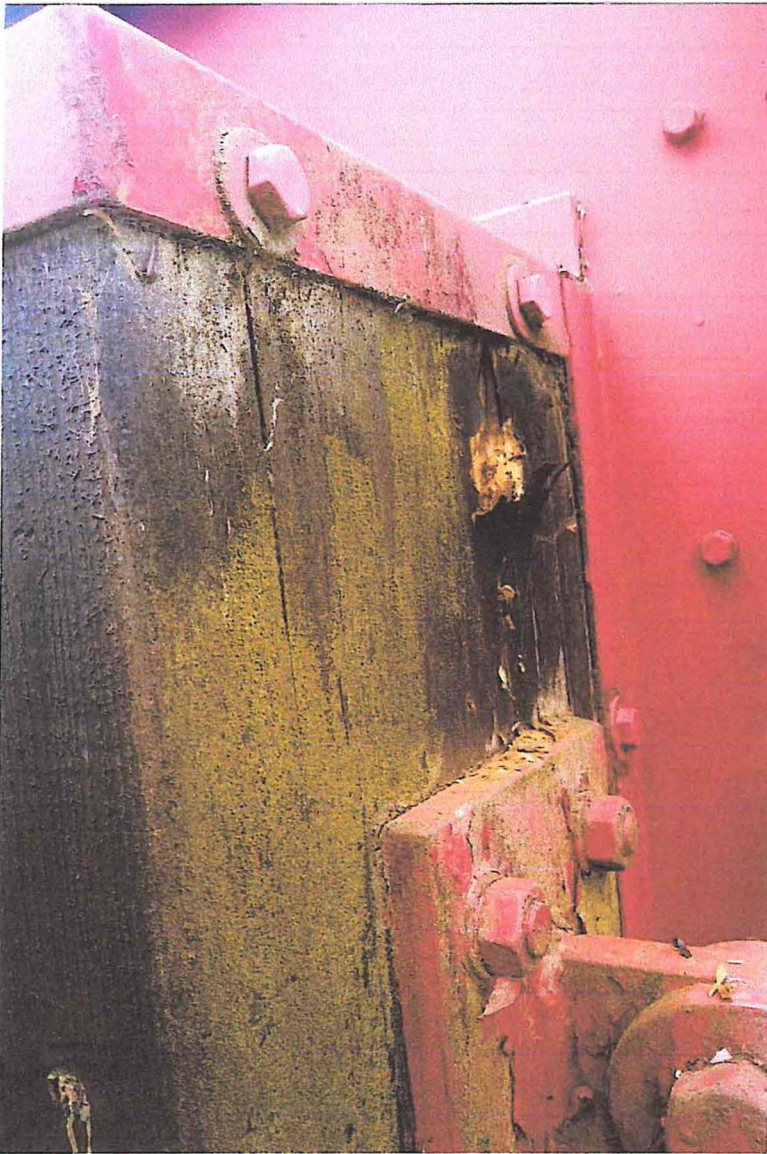
Beginnende Weißfäule unter Abdeckung Ostfassade
