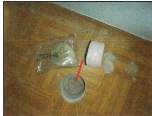
Bild 4: OG, Gruppenraum 3, Fußboden keine Dämmstoffe verbaut in Fußboden unterhalb von Betonestrich
