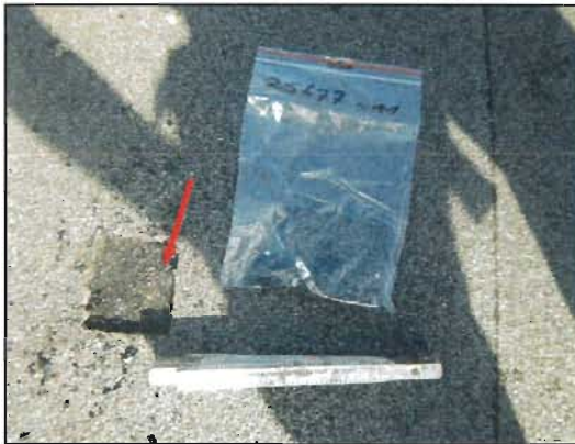
Bild 3: Gebäude, Dach; asbestfreie Teerpappen verklebt mit Dachbetonplatten (Probe 25677-11)
