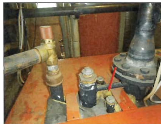
Bild 6: UG, Heizraum, Brennwert-Therme Mineralwolle als Dämmung verbaut in Brennwerttherme
