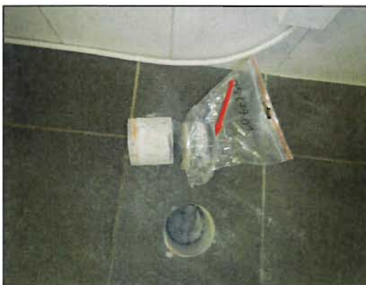
Bild 5: EG, Küche, Fußboden: asbesthaltige Teerpappen verbaut im Fußboden unterhalb von Betonestrich (Probeöffnung 25677-01, Asbestgehalt ins Spuren)
