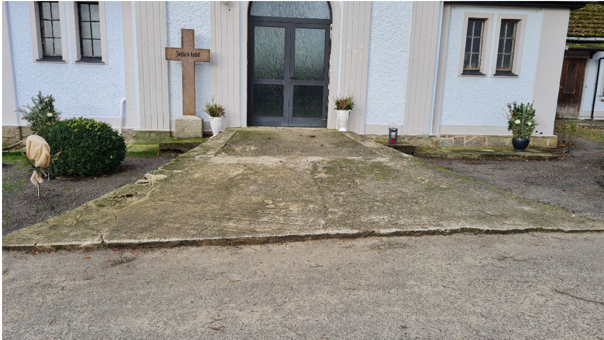
Rampe nachdem der Regen den Splitt weggespült hat (Unfallgefahr am Fußbereich hoch, keine Barrierefreiheit)
