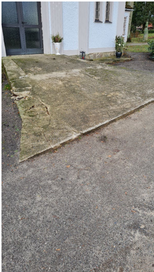
geschädigter Teilbereich + fehlender Splitt am Fußende (Unfallgefahr hoch, keine Barrierefreiheit)
