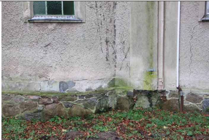
Westseite im Bereich Altarnische Anbindung zum Seitenteil - Risse in der Außenwand - Sockel ist ausgewaschen und Sockelsteine heraus gefallen
