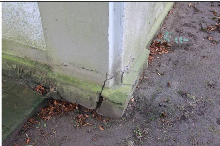
Nord-Ost-Ecke des Mittelteiles - im Fundamentbereich ist die Ecke abgerissen und der Sockelstein heraus gedrückt
