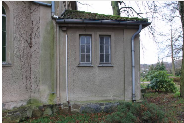
Westseite im Bereich Anbindung Seitenteil - Risse in der Außenwand - Sockel ist ausgewaschen und Sockelsteine sind heraus gefallen
