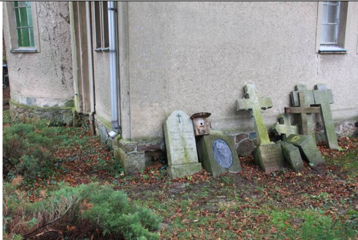
Süd-West-Ecke - Auswaschungen am Sockel
